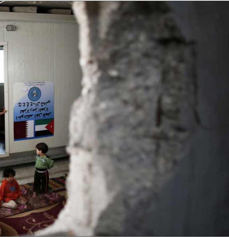
أكدت «الأونروا» أن الأموال التي بحوزتها تكفي فقط لإعادة بناء 200 منزل مدمر كلياً (أ ف ب)
