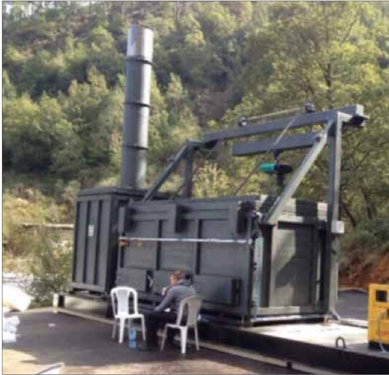
لم تجهز المحرقة بأي نظام لمعالجة الملوثات الناتجة من تشغيلها
